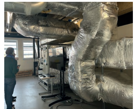
Le Rizomm, centrale de ventilation
